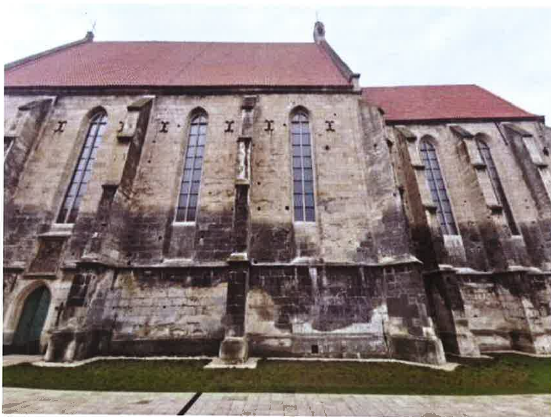
Fot. 18. Kolegiata w Wiślicy, elewacja południowa. Dolna część ścian mocno uszkodzona i zabrudzona. Nad południowym portalem widoczna tablica erekcyjna.
