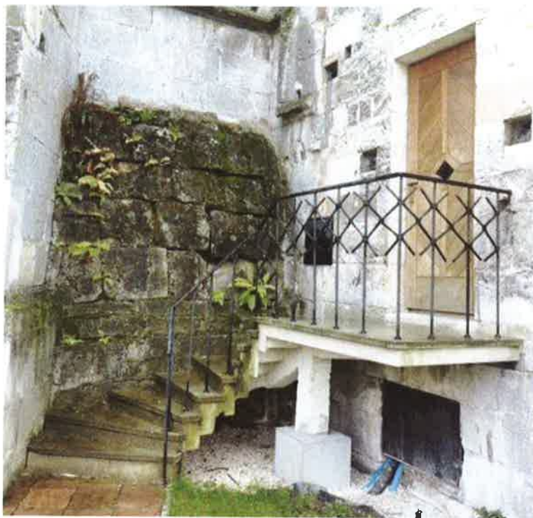
Fot. 13. Kolegiata w Wiślicy, elewacja północna. Widoczne współczesne schody z metalową balustradą i drzwi do zakrystii. Z tyłu za schodami fragment ściany nachylony pod kątem, bardzo zniszczony zabrudzony, fugi wypadły, a w zagłębieniach wyrosły siewki roślin.
