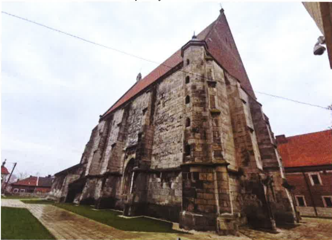
Fot. 5. Kolegiata w Wiślicy, Widok od strony północno-zachodniej. Widoczna najbardziej uszkodzona elewacja północna oraz mocno zabrudzone dolne partie ścian.
