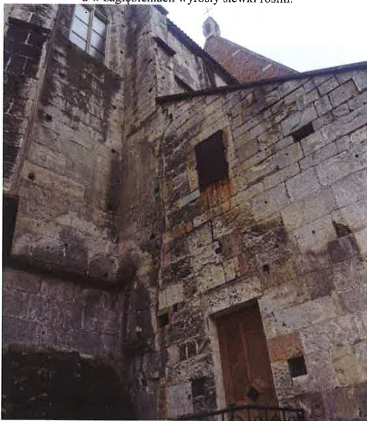
Fot. 14. Kolegiata w Wiślicy, elewacja północna. Widoczne poważne pęknięcie konstrukcyjne na styku przybudówki i kolegiaty. Nad drzwiami zakrystii widoczne metalowe drzwiczki pokryte korozją, pod nimi na ścianie rdzawe zacieki.
