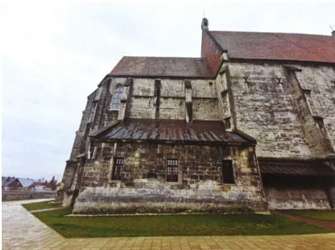
Fot. 11. Kolegiata pw. NMP w Wiślicy, elewacja północna. Widoczna przybudówka (zakrystia) przy północnej ścianie prezbiterium. Powierzchnia ścian zakrystii mocno zabrudzona i pokryta czarną patyną. Pokrycie dachu mocno skorodowane
