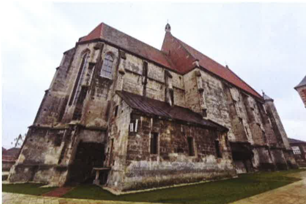
Fot. 12. Kolegiata pw. NMP w Wiślicy, elewacja północna. Widok od strony północno-wschodniej. Ściana północna najbardziej uszkodzona z licznymi ubytkami.
