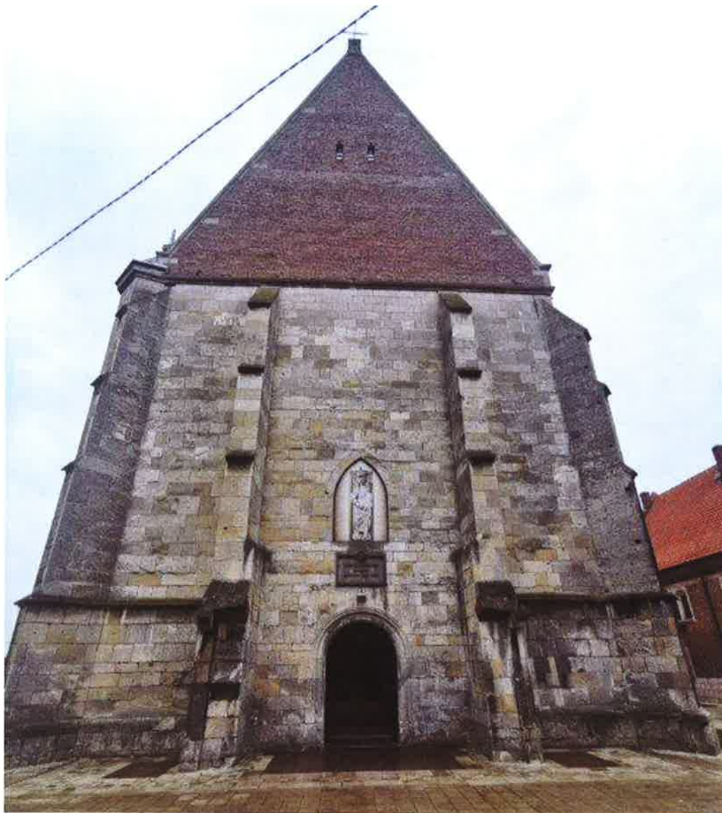
Fot. 1. Kolegiata w Wiślicy, elewacja zachodnia z wejściem głównym do świątyni. Najwięcej zniszczeń widocznych jest w części cokołowej. Powierzchnia jest mocno zabrudzona z czarnymi zaciekami. Miejscami wapień rozwarstwia się, łuszczy się i odpada płatami. Fugi są uszkodzone, miejscami wypadły.
