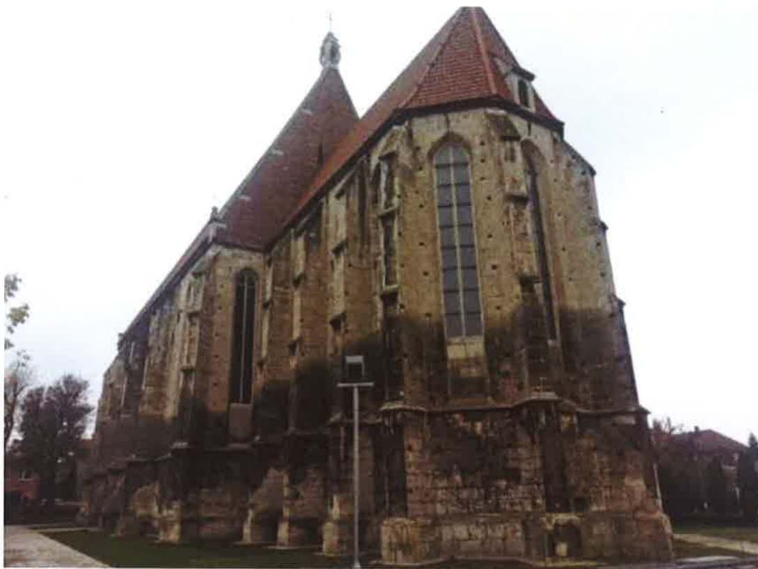
Fot. 15. Kolegiata w Wiślicy, widok na prezbiterium od strony południowo-wschodniej. Widoczne wyraźne zróżnicowanie w stanie zachowania murów kolegiaty, mocno uszkodzone zabrudzone ściany w dolnej części
