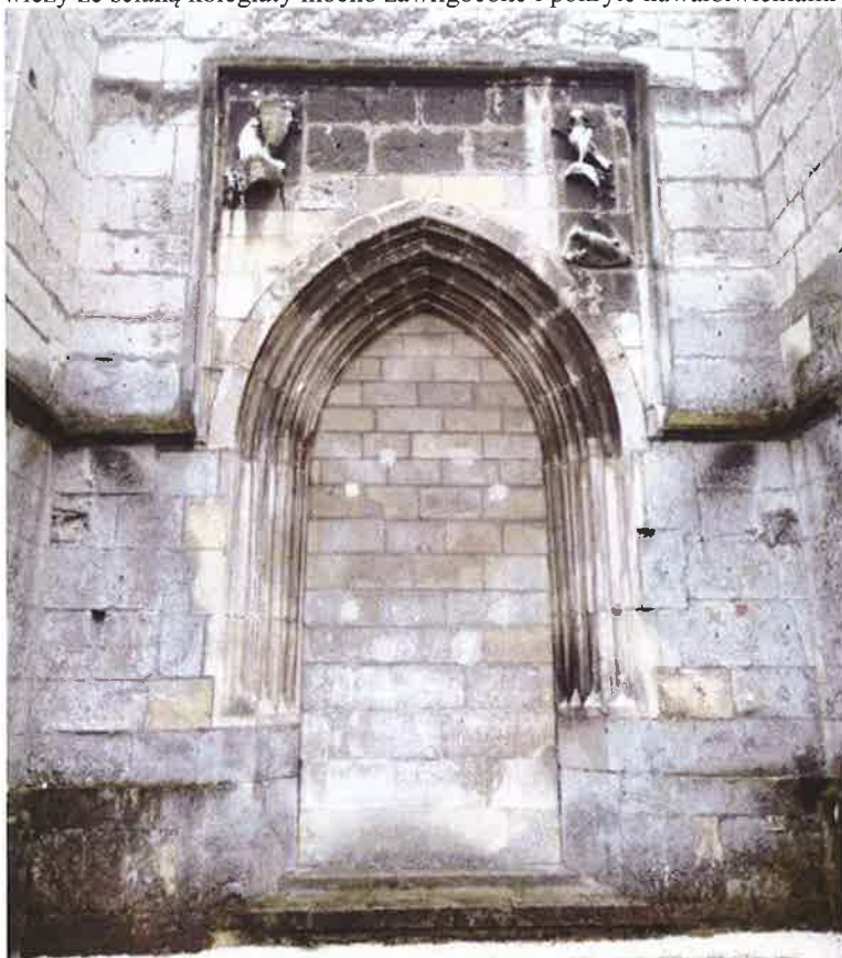
Fot. 7. Kolegiata w Wiślicy, elewacja północna. Bogato profilowany, ostrołukowy portal wraz z dekoracją heraldyczną. Widoczne mocno zabrudzone profilownia zwieńczenia portalu i uszkodzone, przemyte i wyoblone płaskorzeźby heraldyczne.
