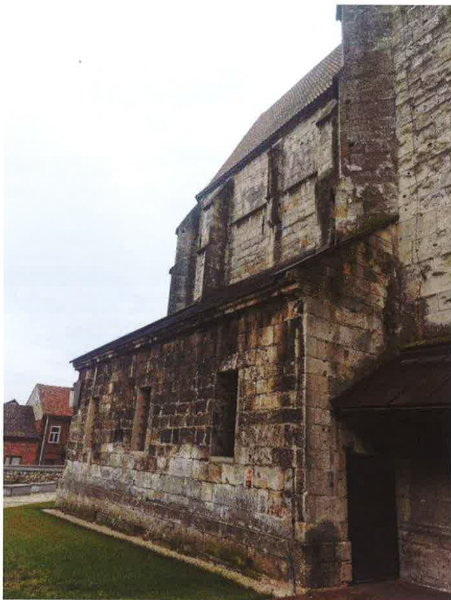
Fot. 10. Kolegiata pw. NMP w Wiślicy, elewacja północna. Widoczna przybudówka (zakrystia) przy północnej ścianie prezbiterium. Widoczne bardzo mocne zabrudzenia i uszkodzenia kamienia.
