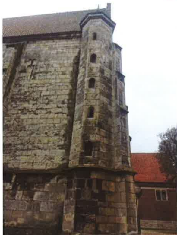
Fot. 6. Kolegiata w Wiślicy, elewacja północna. Widoczna wieża schodowa w północno zachodnim narożniku kolegiaty. Miejsca styku wieży ze ścianą kolegiaty mocno zawilgocone i pokryte nawarstwieniami biologicznymi.
