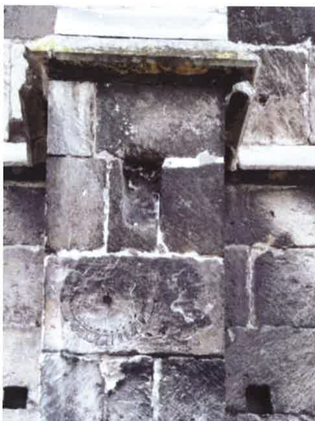
Fot. 16. Kolegiata w Wiślicy, elewacja południowa. Widoczny schematyczny zegar słoneczny wryty na przyporze ściany prezbiterium pierwszej przy ścianie tęczowej. Widoczne uszkodzenia gzymsów i ciosów wapiennych.
